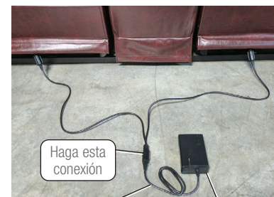
Cable corto del cable en Y
