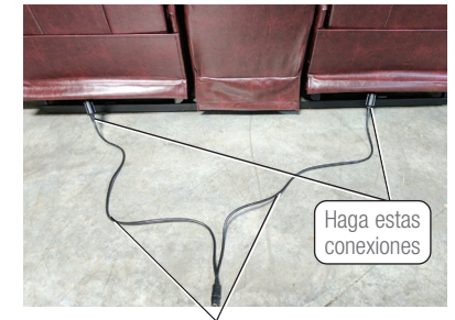
Cables largos del cable en Y
