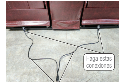
Cables largos del cable en Y
