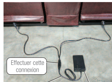
Cordons courts de câble Y Transformateur électrique
