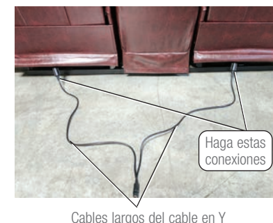
Cables largos del cable en Y
