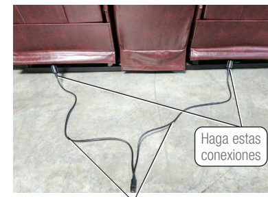
Cables largos del cable en Y
