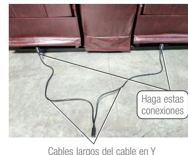
Cables largos del cable en Y
