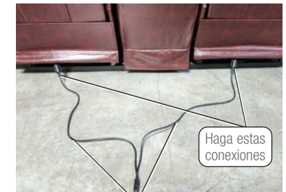
Cables largos del cable en Y
